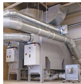
Absaugproblem kreativ gelöst: Entstauber-Batterie von Spänex
