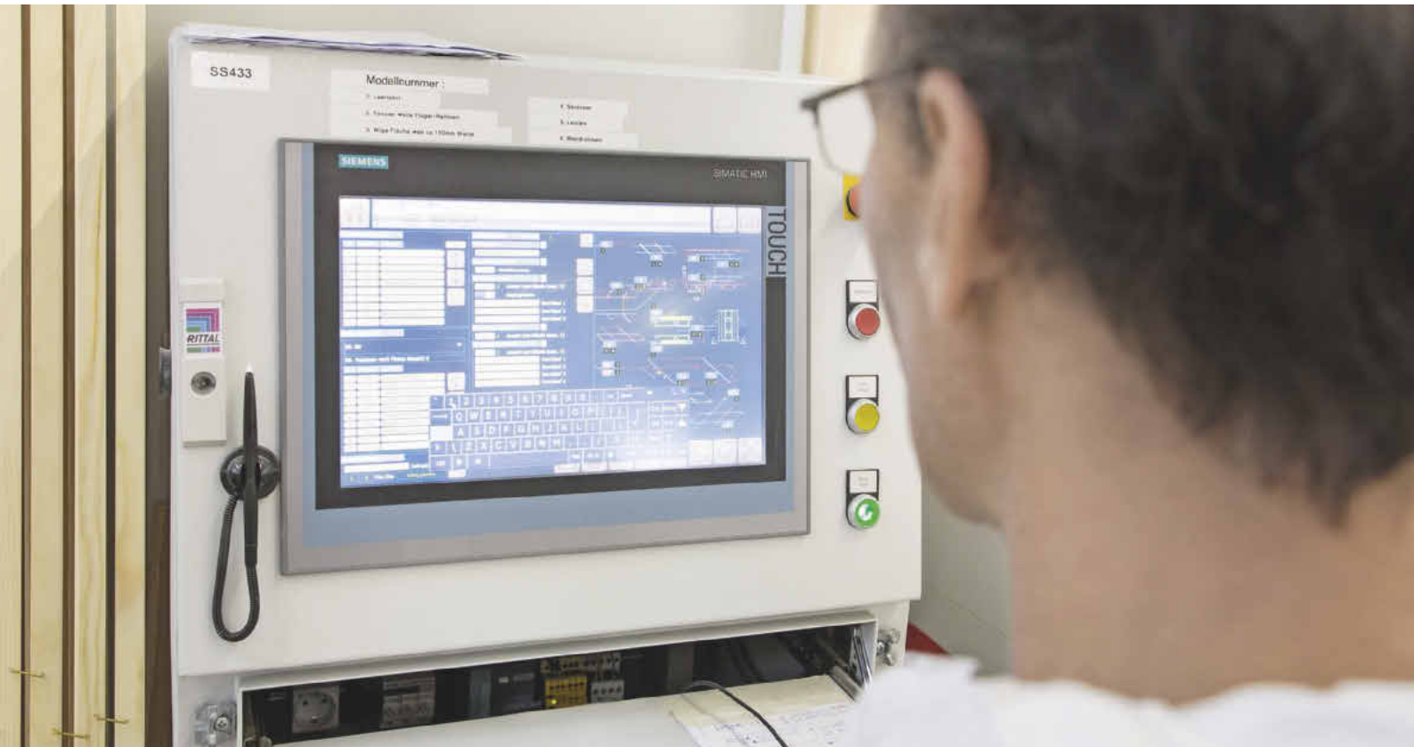
In industriellen Fensterlackieranlagen wird der komplette Prozess über einen Leitrechner gesteuert
