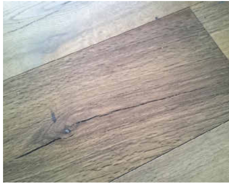
/ Tolerierbare Trockenrisse entstehen durch übermäßige Austrocknung und durch große Schwindspannungen.
