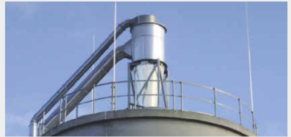
Der Zyklon am Silo sorgte für eine drucklose Einbringung des Materials.
