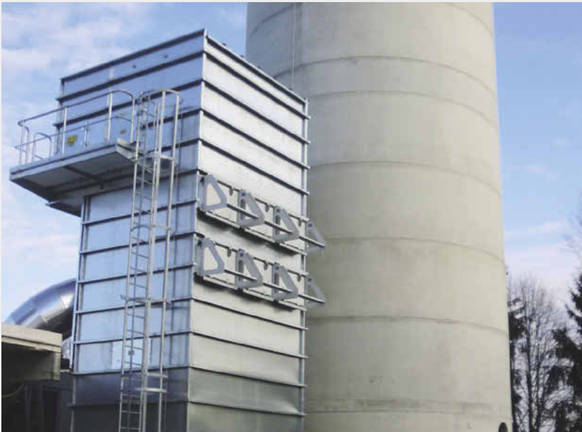
Bei der Möbelbau Breithenthaler GmbH wurde ein LIGNO-Impulsfilter errichtet.
