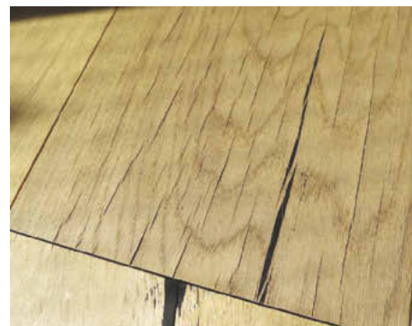
/ Mikro- und Trockenrisse verschließen sich meist im Sommer wieder und sind oft gar nicht mehr sichtbar.
